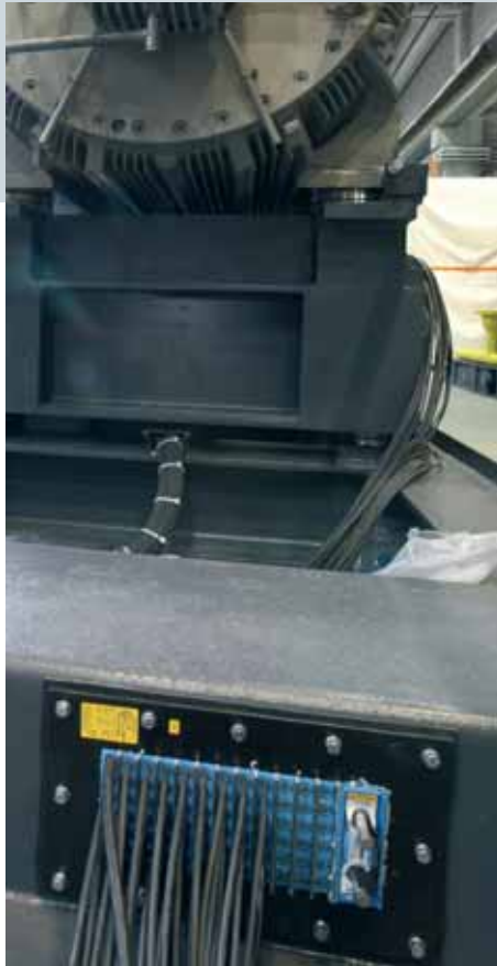
Un autre «petit» détail: Tous les câbles, étanche au gaz, arrivent dans l'armoire électrique à travers le châssis du groupe de compresseurs.
