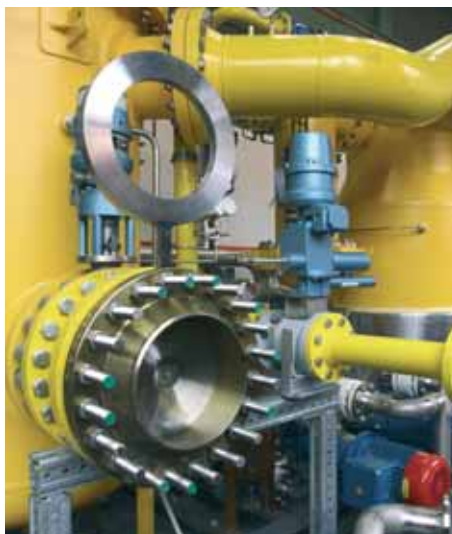
Les composants imposants de l'unité fonctionnelle: À gauche, le filtre destiné à l'épuration du gaz avec l'importante conduite d'aspiration du compresseur, au centre de l'image le séparateur d'huile et au premier plan la conduite de refoulement beaucoup plus petite.
